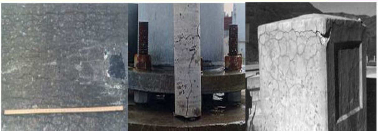
ترک خوردگی بر اثر ASR
